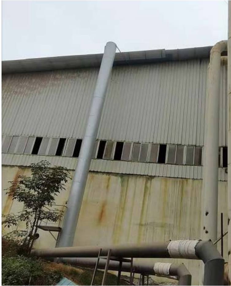
图 4-7 包装废气排气筒
