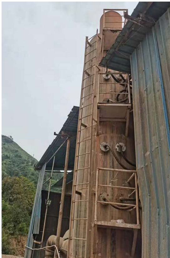
图 4-4 回转窑废气处理设施（碱液喷淋+尿素脱硝）
