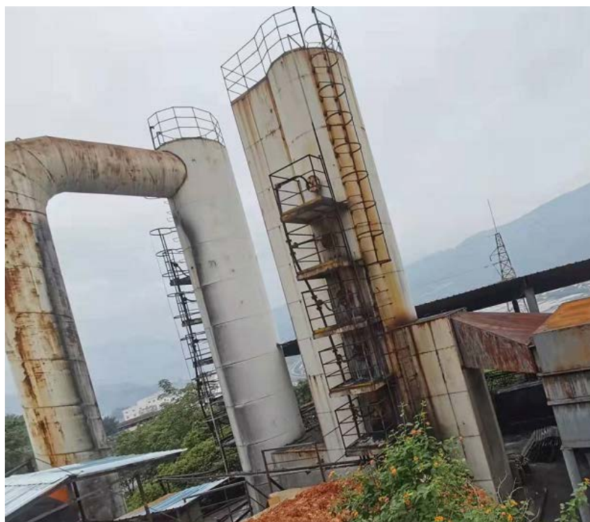
图 4-5 锅炉除尘脱硫脱硝系统（双碱脱硫+尿素脱硝）
