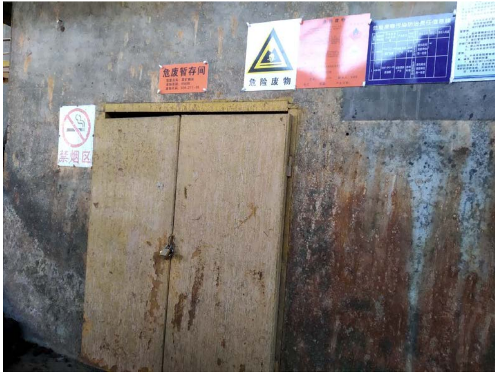
图 4-8 项目危废暂存间
